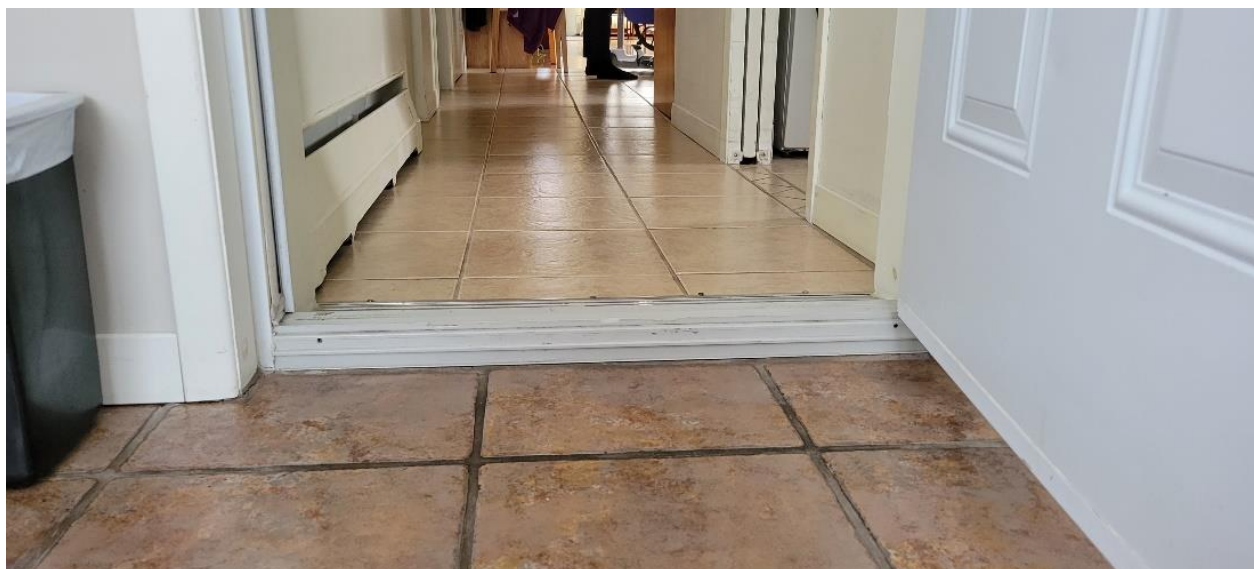
Image 2 Hauteur du seuil de porte entre le solarium et le reste de la maison.
