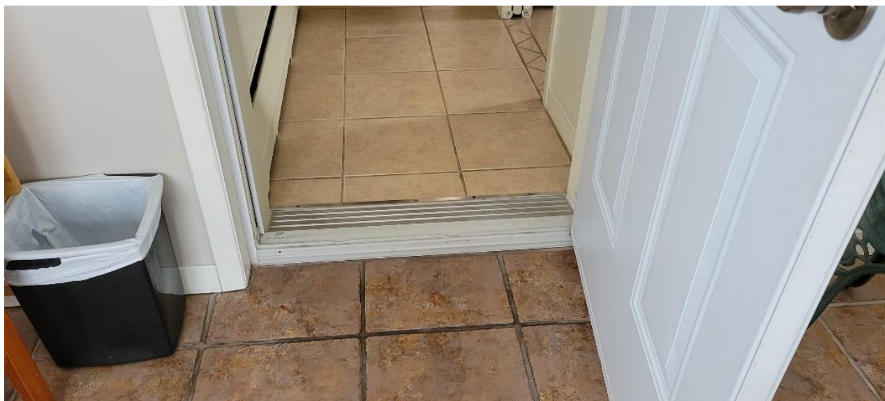
Image 1 Seuil de porte entre le solarium et le reste de la maison.
